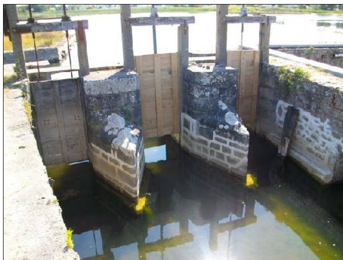
Photo 6: Système de vannage dans la digue de Kermor - source : SIVOM Combrit
